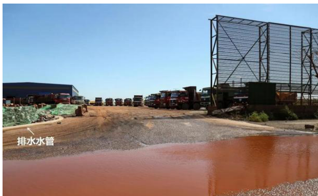
图3 堆场出口用水管向外排出的水
