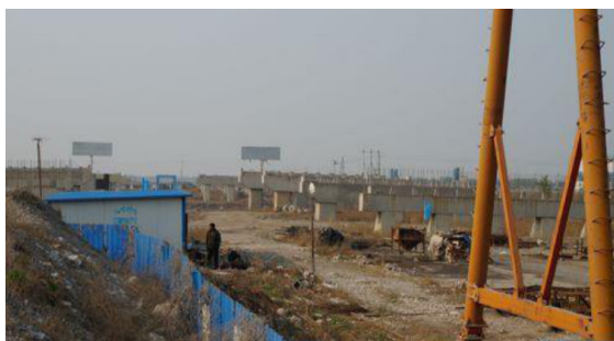
图1 漆曹大桥“烂尾”
