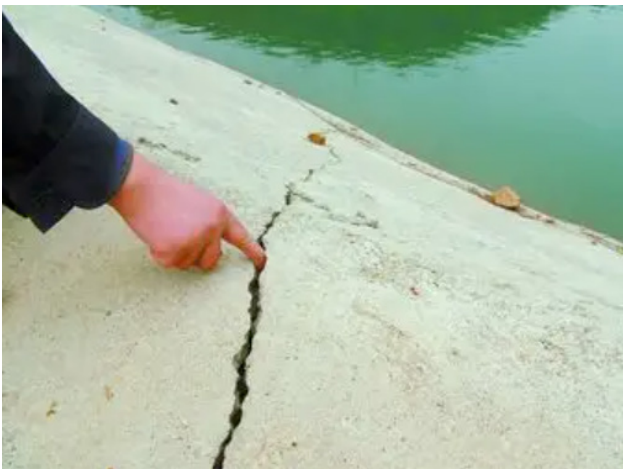
图2 某水库坝体发生的裂缝问题
