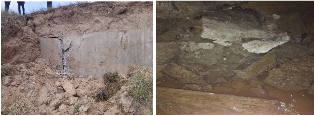
图1 107 + 044.74m 处暗渠伸缩缝处内外严重挤压变形破坏情况
