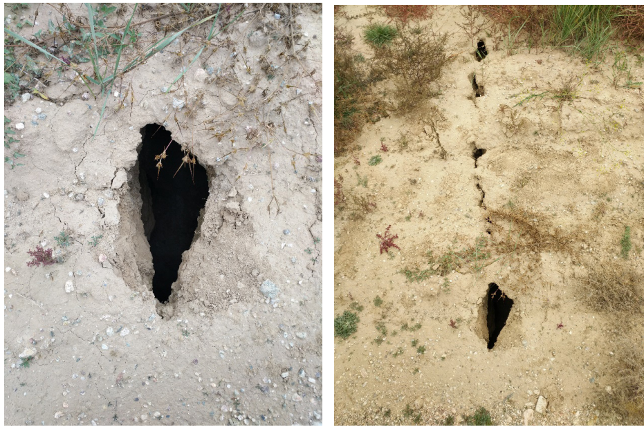
图3 内外水浸泡引起暗渠两侧填土湿陷开裂
