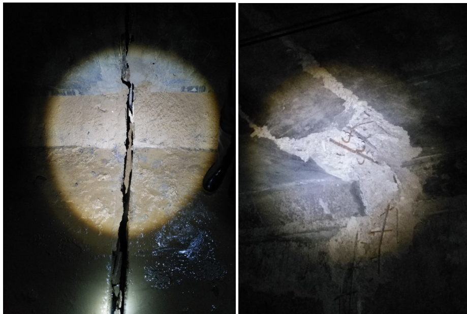
图2 暗渠一般变形破坏情况（伸缩缝开裂，混凝土保护层剥落）
