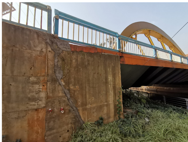
图1 桥台和道路连接处出现裂缝
