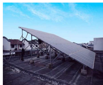
图3 太阳能光伏发电
